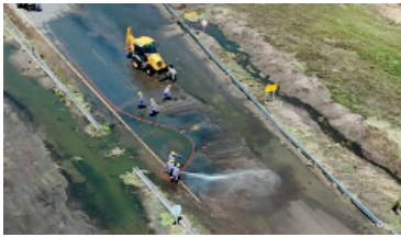
El derrame sobre la ruta 11.
