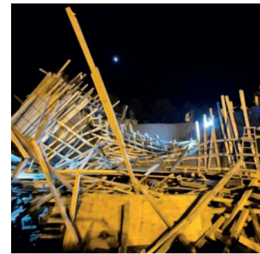
La obra que se derrumbó en Costa Esmeralda. - 0223 -
