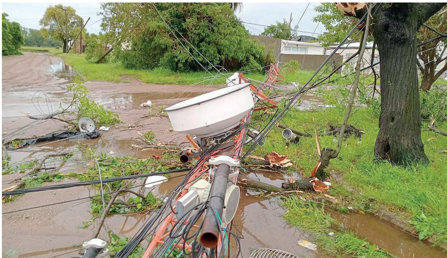
■ Cayeron postes de luz, lo que provocó cortes de electricidad en la ciudad del partido de Bolívar.
